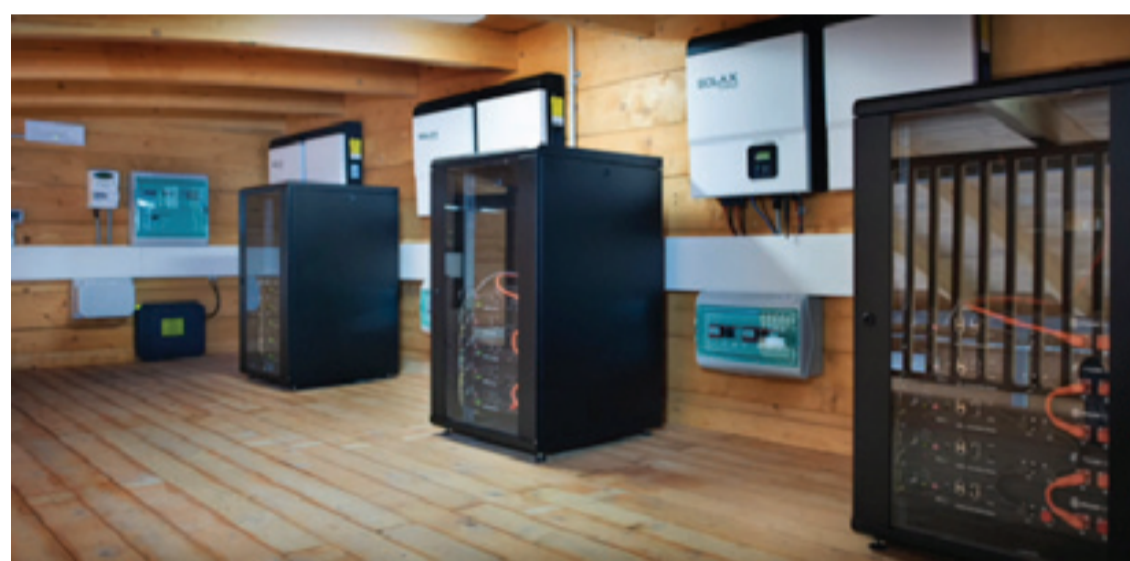
TRE SISTEMI DI ACCUMULO MONOFASE SOTTO UN UNICO POD TRIFASE. I SISTEMI DI ACCUMULO SCAMBIANO ENERGIA TRA LORO TRAMITE IL GATEWAY "SNOCU" DI REGALGRID INTEGRATI AGLI INVERTER
