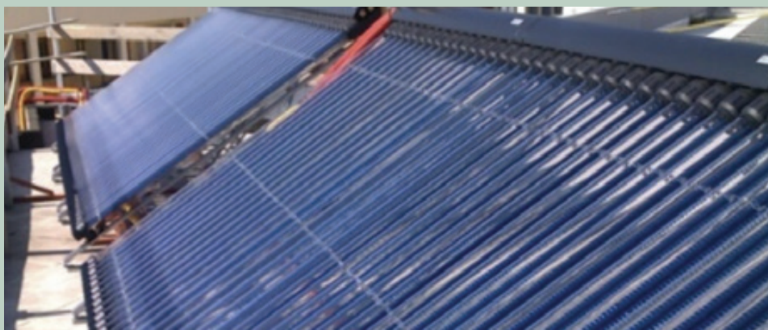
FIGURA 2 - PANNELLI A TUBI SOTTOVUOTO INSTALLATI SU COPERTURA PIANA
