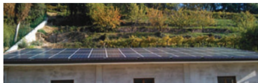
Inserimento storage su impianto nuovo
