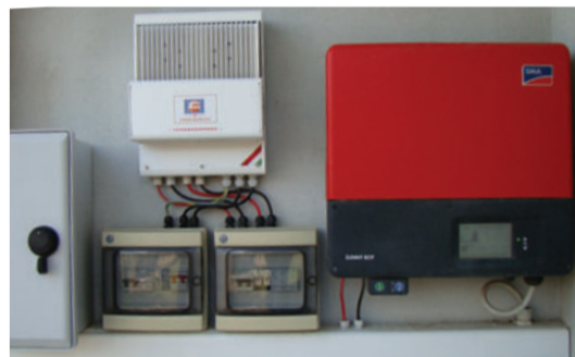
Inserimento storage su impianto allacciato in precedenza
