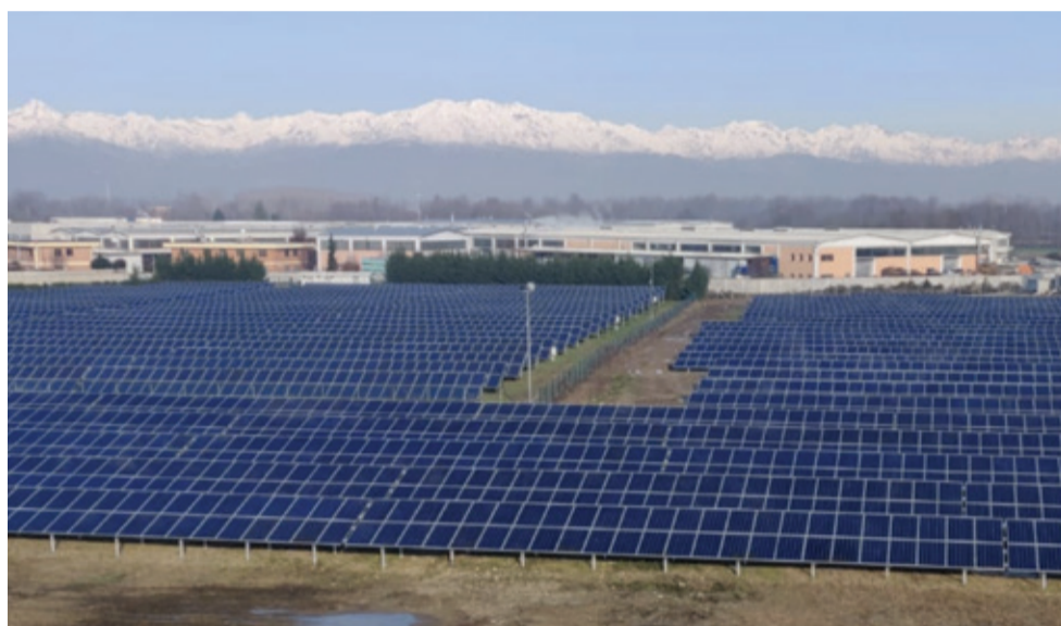
L'IMPIANTO FOTOVOLTAICO AFFIANCA UNA CENTRALE DA 993 KWP REALIZZATA NEL 2011 E IN REGIME DI 4° CONTO ENERGIA
