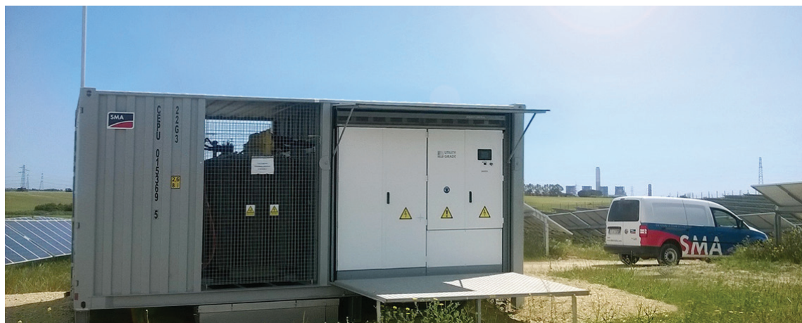
SMA SI È OCCUPATA DELLA FORNITURA DI 58 INVERTER SMA SUNNY CENTRAL CP-XT OUTDOOR
