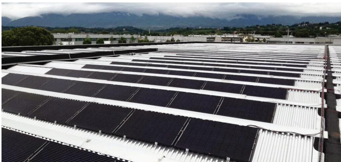
L'IMPIANTO, CHE OGNI ANNO POTRÀ PRODURRE CIRCA 355 MWH, È COSTITUITO DA 1.066 MODULI MONOCRISTALLINI AD ALTA EFFICIENZA SOLARWORLD E 11 INVERTER TRIFASE SMA SUNNY TRIPOWER
