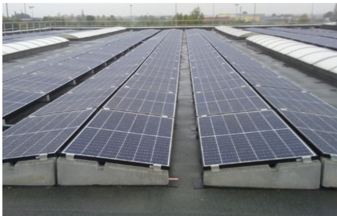
L'IMPIANTO È COSTITUITO DA MODULI REC SOLAR ALLACCIATI A INVERTER SMA. I SISTEMI DI MONTAGGIO SONO INVECE A MARCHIO SUNBALLAST
