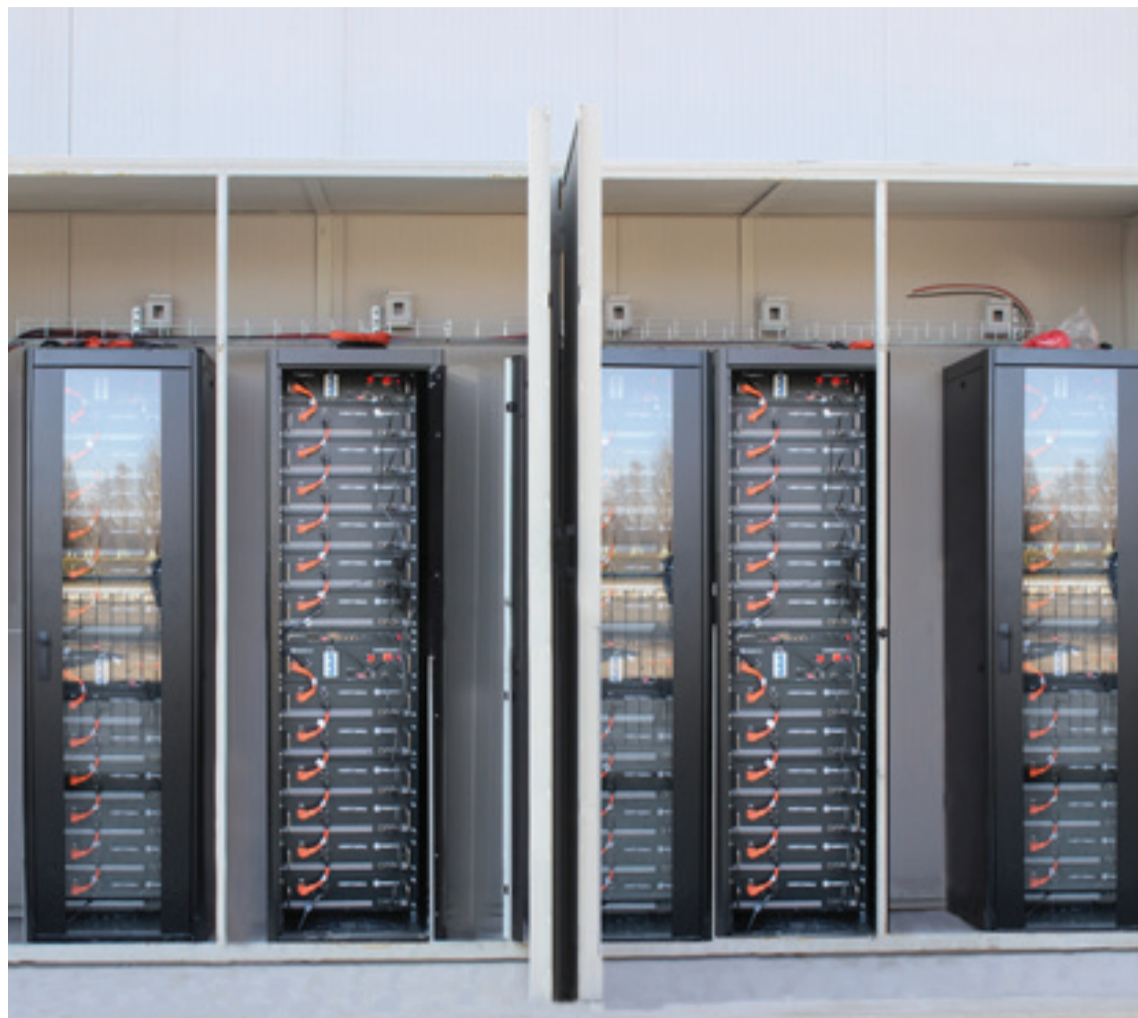
OGNI INVERTER IBRIDO È CONNESSO AD UN ACCUMULO CON CAPACITÀ DI 42 KWH, REALIZZATO CON DUE PILE IN PARALLELO DA SEI BATTERIE PYLONTECH, CON CAPACITÀ DI ACCUMULO DI 3,5 KWH CIASCUNA
