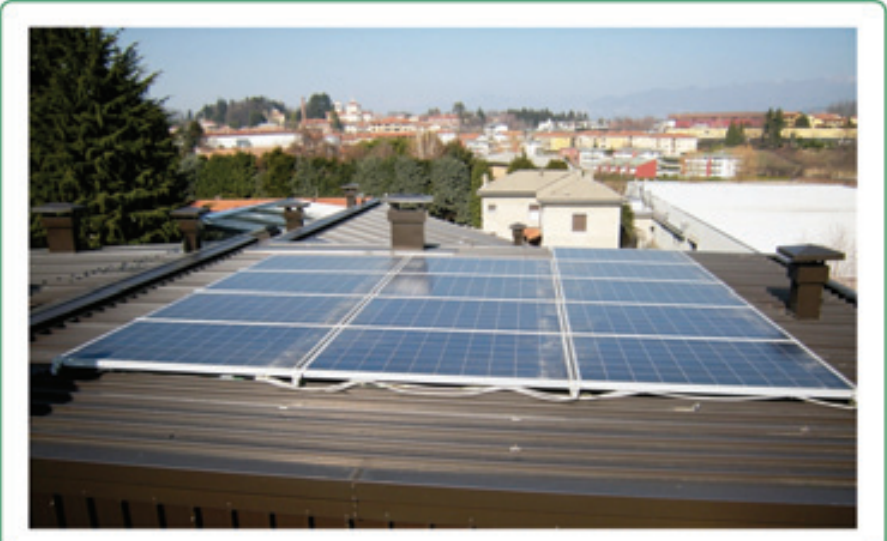
Fig. 5. L'impianto fotovoltaico a servizio delle utenze condominiali.
