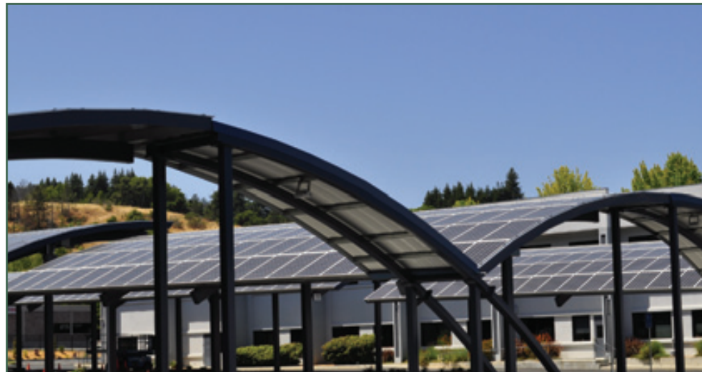
Santa Cruz, California - 800 kWp, installazione retrofit dell'ottimizzatore Tigo Energy su parcheggio
