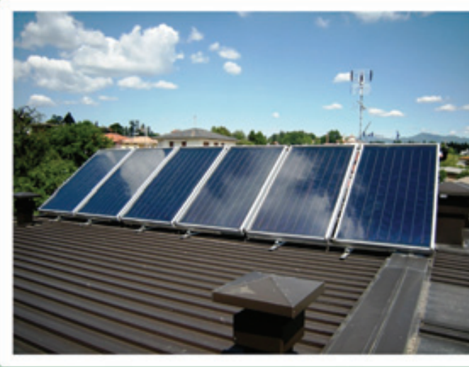
Fig. 2. I collettori dell'impianto solare termico.
