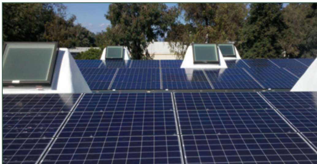
Sunnyvale, California - 113 kWp, soluzione Tigo Energy integrata nella cassetta di giunzione del modulo FV
