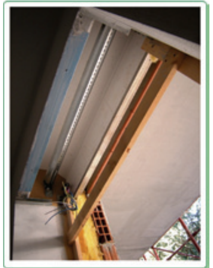
Fig. 4. Particolare della stratigrafia della parete verso l'esterno (lato Ovest) e del cassonetto isolato. Fotografia scattata durante i lavori di costruzione.
