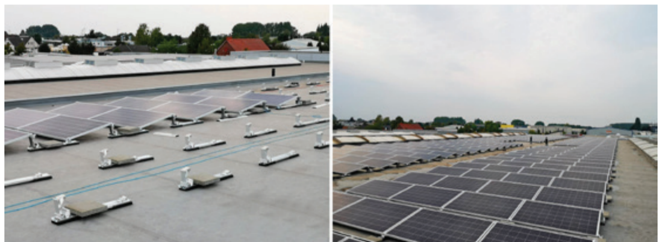
IL TETTO PIANO HA UN IMPIANTO FOTOVOLTAICO CON UN TOTALE DI 724 MODULI E UNA POTENZA DI 199,10 KWP. IL SISTEMA DI MONTAGGIO ADATTO È LA S-DOME V 10°
