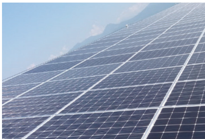
L'IMPIANTO È COSTITUITO DA OLTRE 3MILA MODULI AD ALTA EFFICIENZA VISSMANN, ALLACCIATI A 26 INVERTER HUAWEI E A 6 INVERTER SOLAREEDGE CON OTTIMIZZATORI. OGNI ANNO L'INSTALLAZIONE PRODURRÀ CIRCA 1,3 GWH
