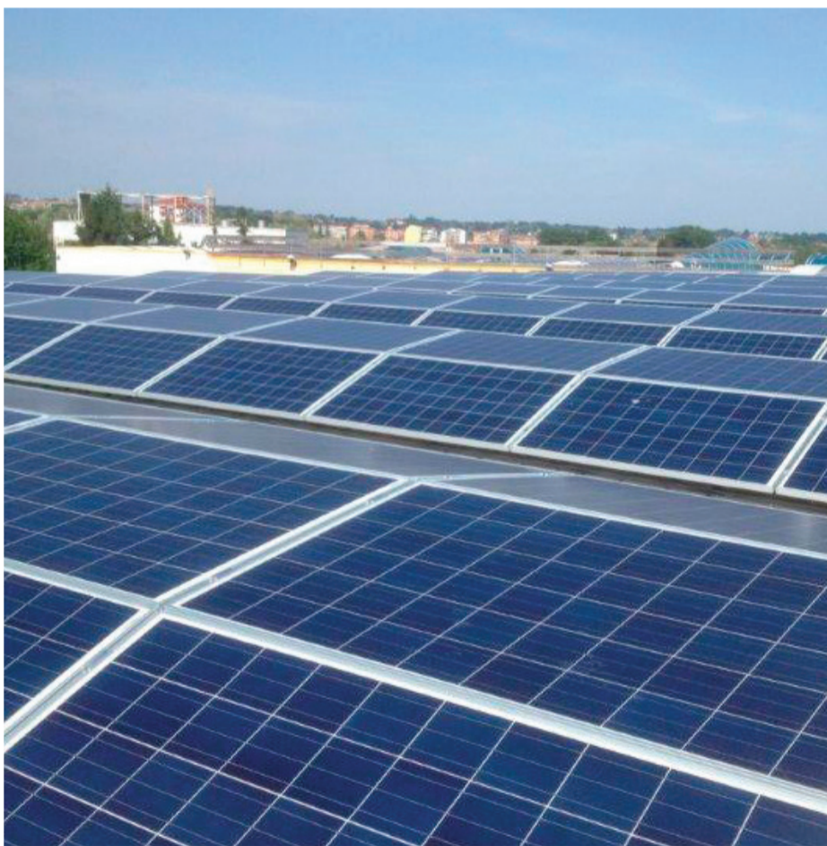
Impianto su capannone industriale da 229,5 kw realizzato con moduli WRS255W – ST60C a Cerreto Castello (BI) a cura di CDNE
