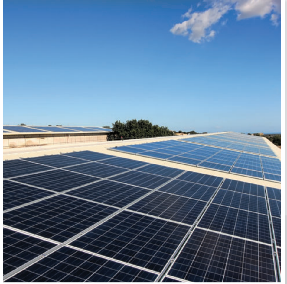
Impianto su capannone industriale da 200 kw realizzato con moduli WRS250W – ST60C a Modica (RG)
