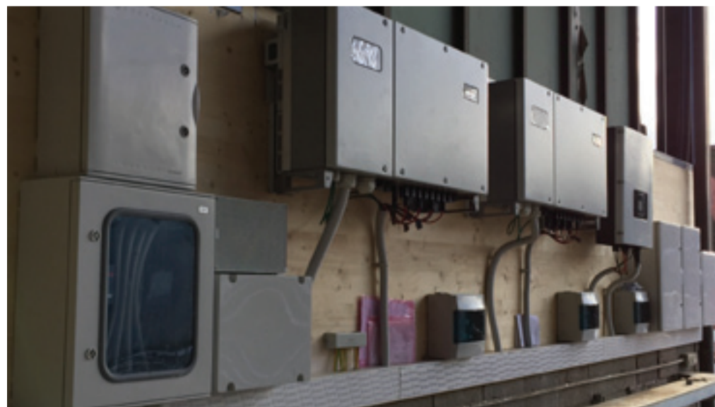
I MODULI SONO ALLACCIATI A 4 INVERTER FORNITI DA HUAWEI TECHNOLOGIES
