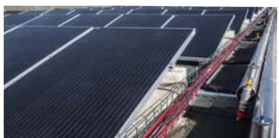
IN FOTO, UN DETTAGLIO DELL'IMPIANTO PILOTA DA 20 KWP (70 KWH IN TERMINI DI POTENZA TERMICA) INSTALLATO IN EMILIA ROMAGNA.
