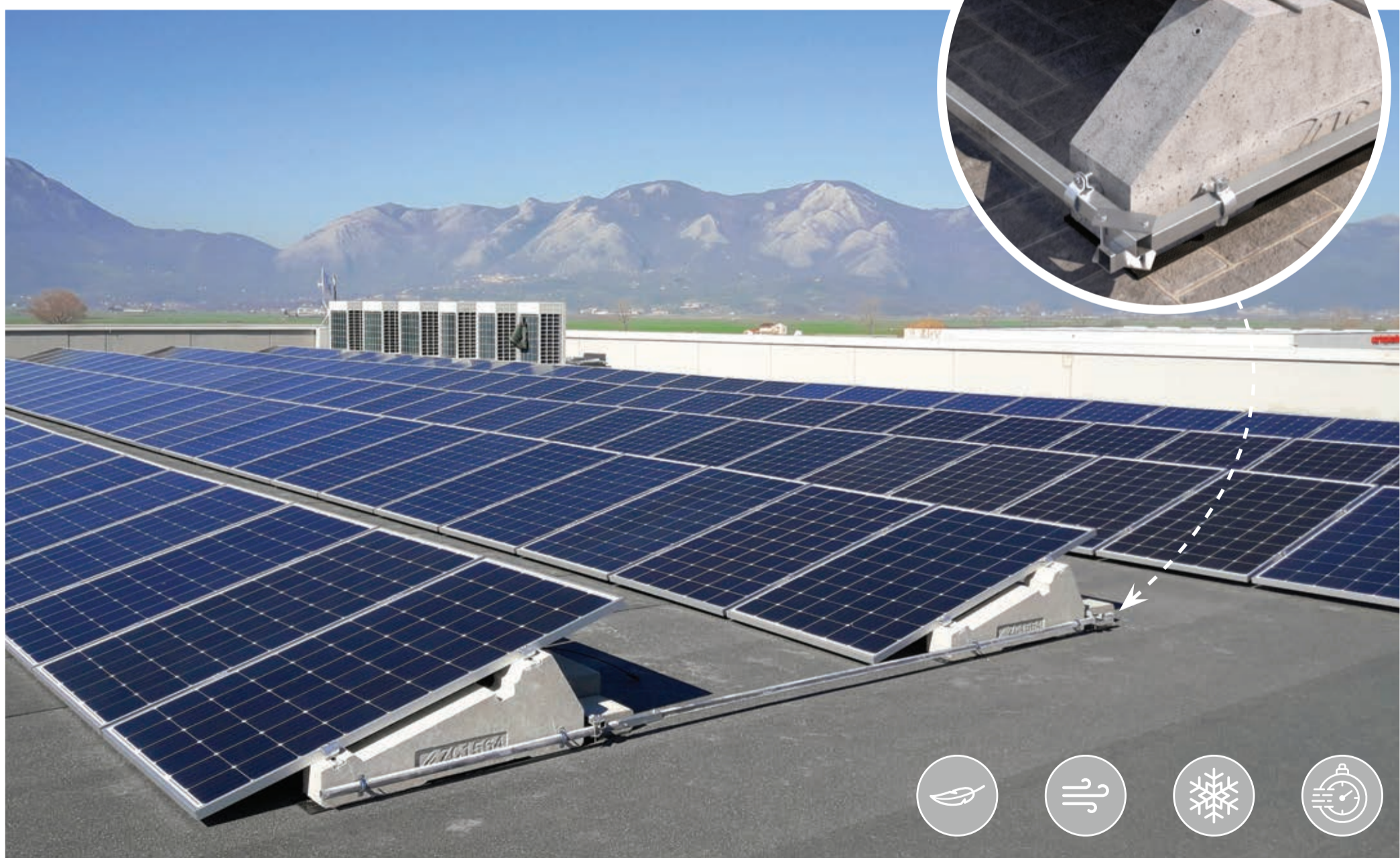
Impianto con controventi
