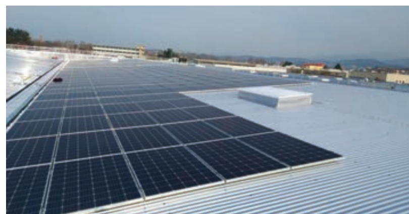
JA SOLAR HA FORNITO I MODULI, CHE SONO EQUIPAGGIATI CON OTTIMIZZATORI E ALLACCIATI A INVERTER SOLAREDEGE. GEWISS, INVECE, HA FORNITO I LED PER IL RELAMPING
