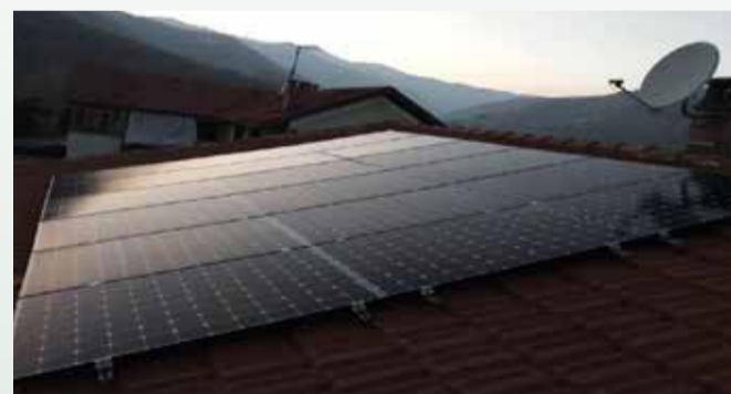
UN IMPIANTO SU UNA CASA GAS FREE A PINEROLO (TO). PRECEDENTEMENTE ALIMENTATA A METANO CON RADIATORI IN GHISA
